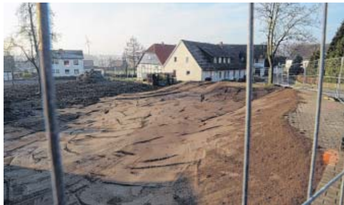
Geräumt: Nach dem Abbruch der früheren Bäckerei wurde jetzt der Kellerraum unterhalb der Straße „Am Kirchplatz“ verfüllt.
